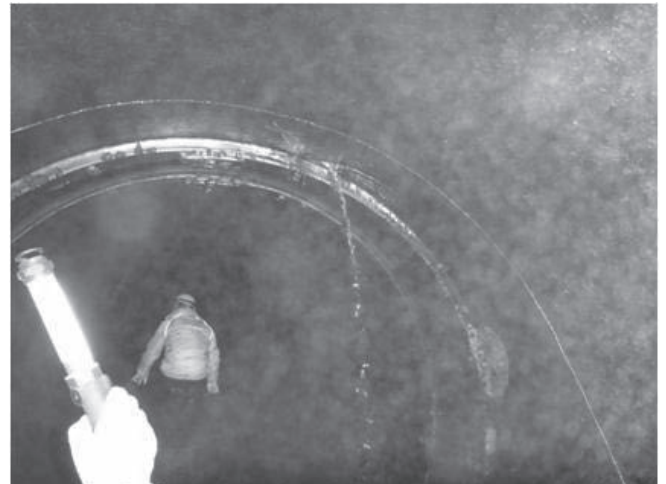
写真-2 既設内面バンドの劣化状況（水の噴出）
