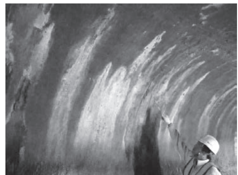
写真－2 漏水・遊離石灰状況
