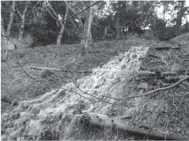
写真-1 宮川サイホンでの漏水状況
