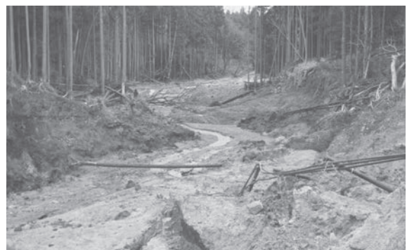
写真-2 下流水路の流失後の状況
