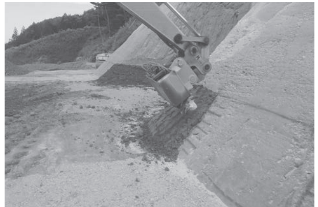
写真-13 コア材が基礎地盤に接続する箇所のコンタクトクレイ施工状況
