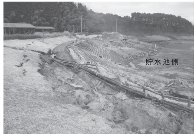
写真-7 親水護岸の崩壊・変形状況
