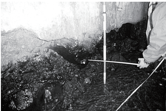
写真-2 トンネル部における洗掘による覆工コンクリートの流亡状況
