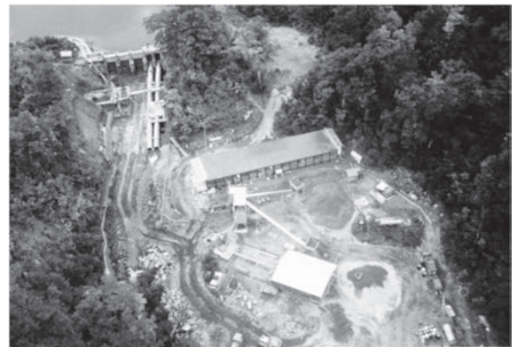
写真-6 工事現場全景 (左上が制水門、中央が現場事務所兼労務者宿舎)
