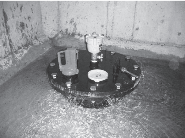
写真-8 フランジ部からの漏水
