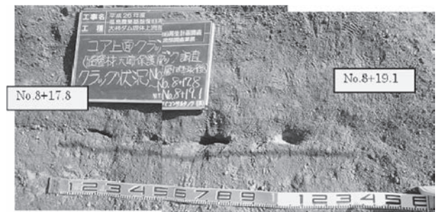
写真-2 経時後の天端クラック状況
