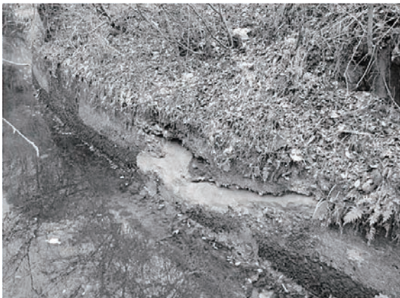
写真-3 開水路における側壁の劣化状況
