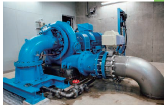
④小水力発電施設の整備
