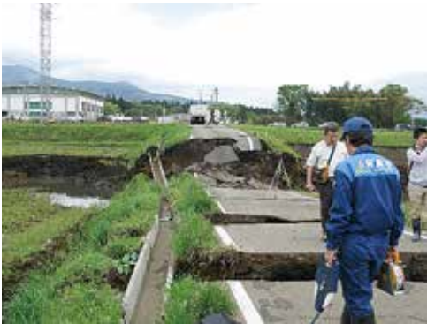
①被災状況1 (農道)
