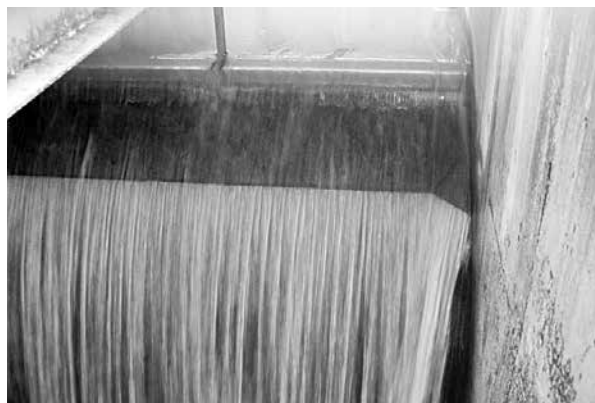
写真-5 隔壁からの越流状況（スタンド分水工内）
