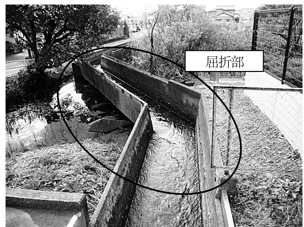
写真-2 既設水路の屈曲部（整備前）
