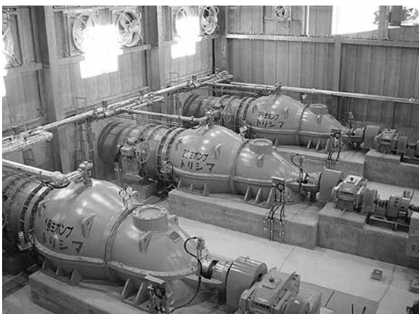
写真-5 新設本郷排水機場内部 (洪水用ポンプ 1,500mm×3台)
