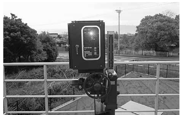
写真-3 分水調整ゲートの遠方監視制御設備
