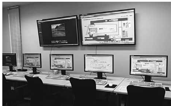
写真-6 設置が完了した水管理システム（親局）
