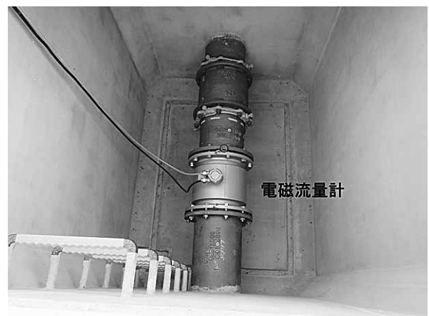
写真-4 流量監視設備
