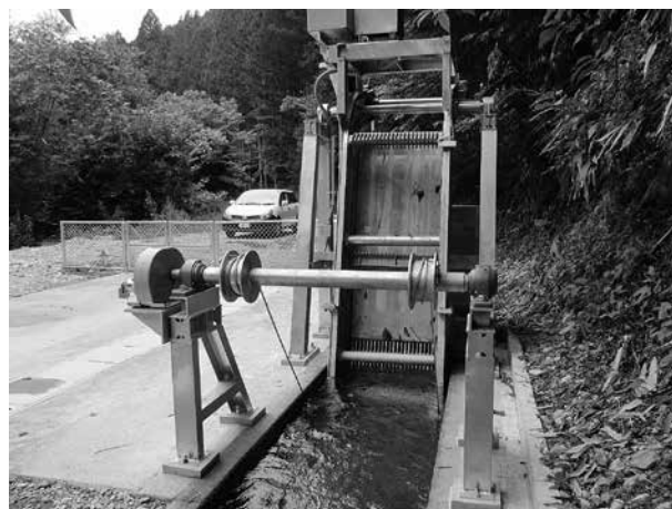
写真-12 頭首工付近に設置した除塵機
