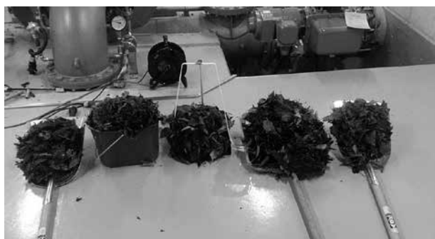
写真－13 発電機より取り出されたゴミ
