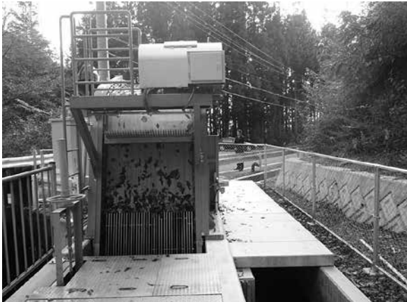
写真-6 ヘッドタンクにあるスクリーン
