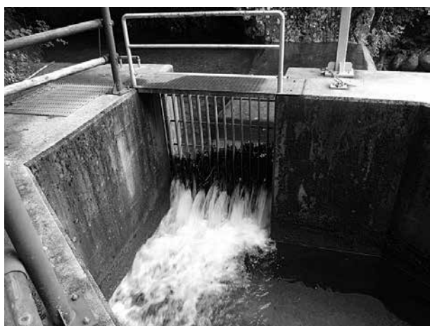
写真-10 頭首工スクリーンのゴミ詰まり
