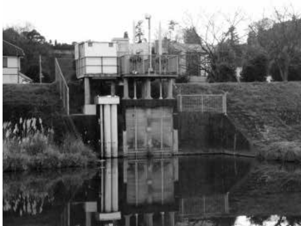
写真－7 遠隔化された取水ゲート
