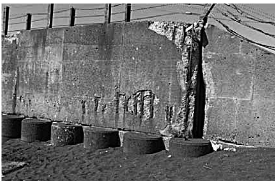
写真-3 開渠工河口部鉄筋腐食状況
