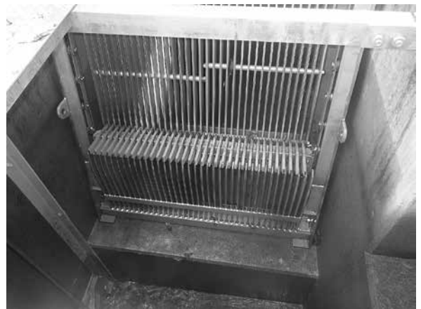
写真-8 除塵機のスクリーン (改修前)
