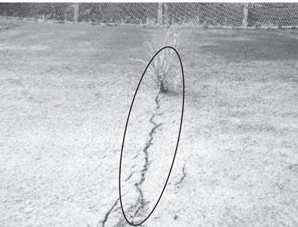
写真-4 舗設継ぎ目開口例（気中部）
