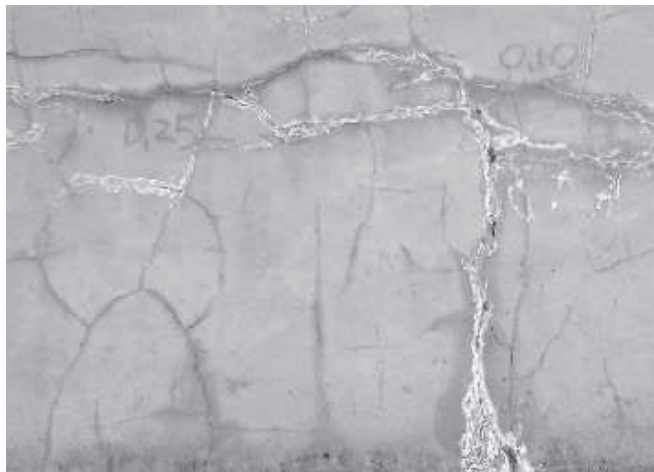
写真－４ 表面被覆材のひび割れ
