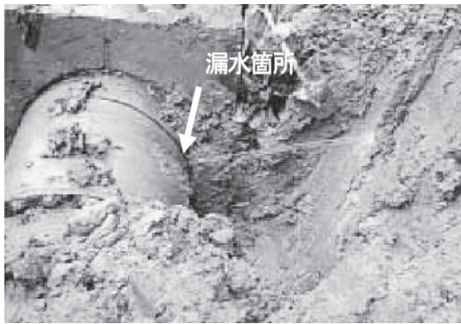
写真-2 掘削による漏水確認
