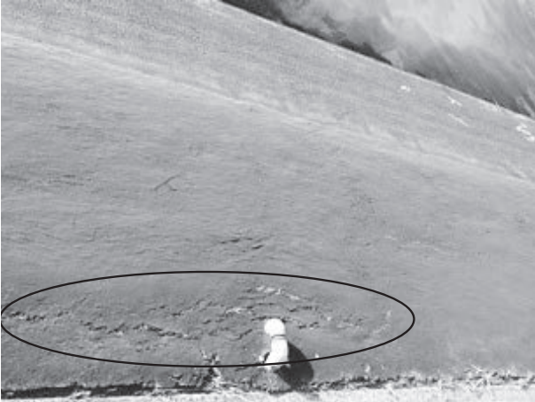
写真-3 堤頂近くのクラック
