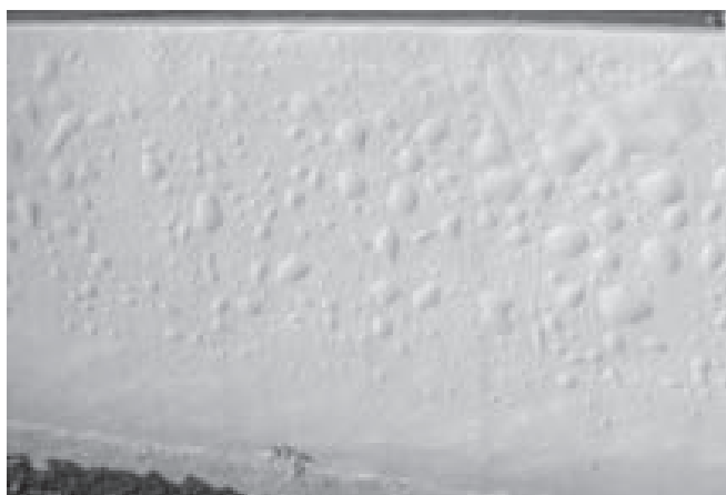
写真－５ 表面被覆材の膨れ
