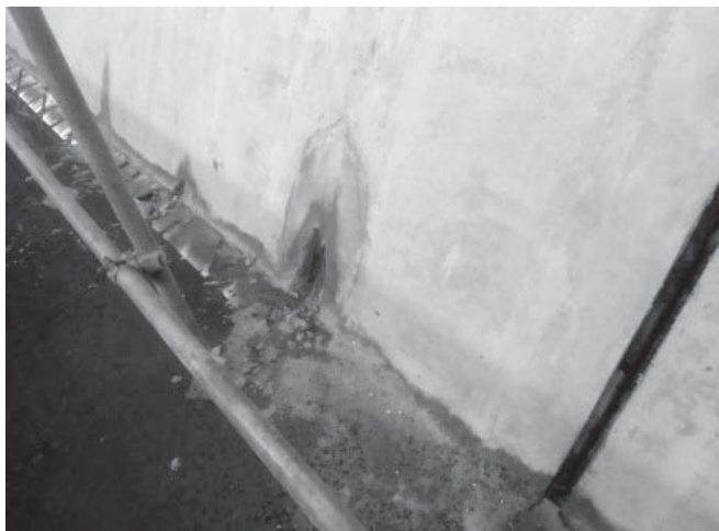
写真－４ 目地からの湧水によるモルタル分の抜け
