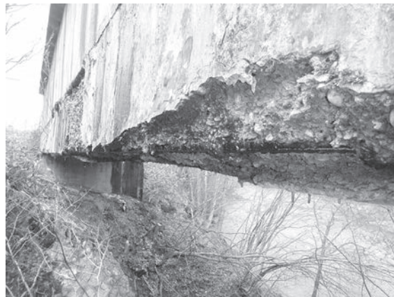
写真-1 コンクリートの剥落状況
