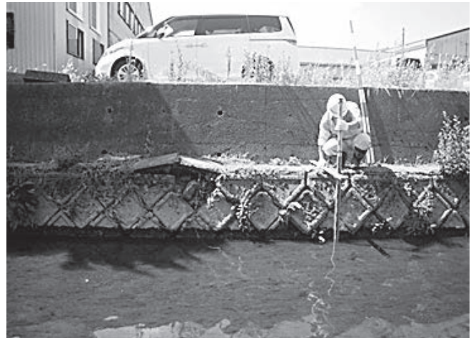
写真-2 損傷状況
