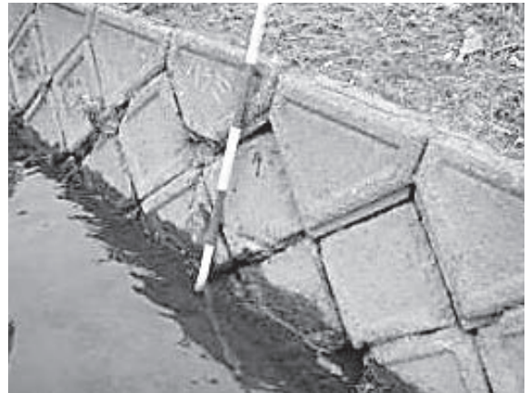
写真-3 既設護岸の損傷状況 (ハラミ出し)
