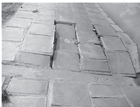
写真-6 パネルの変状部分
