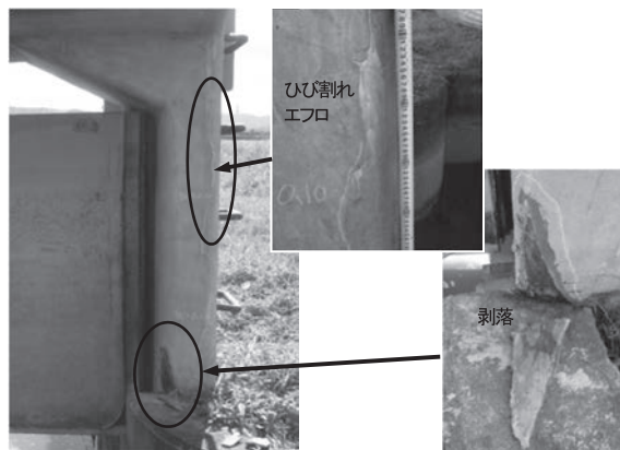
写真-7 B工法の門柱の状態
