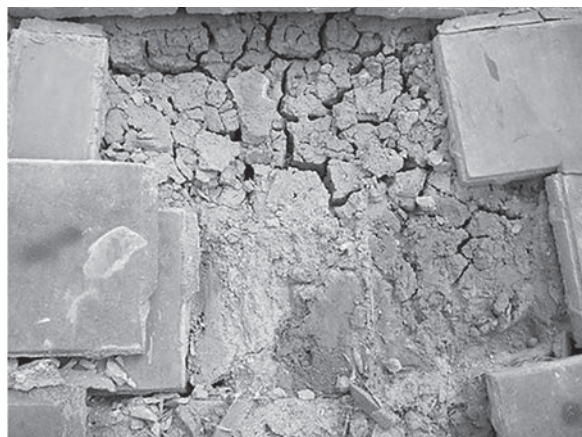
写真-7 変状パネル背面の状況
