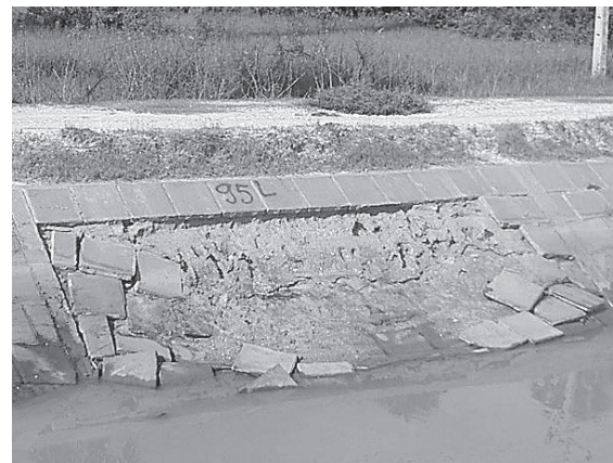
写真-2 パネルの崩落(2012年調査)
