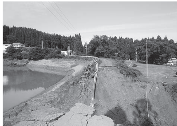
写真－4 農業用ため池が決壊した男鹿市真山地区
