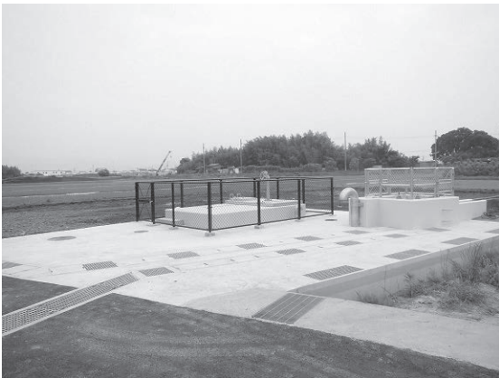
写真-15 分水工全景
