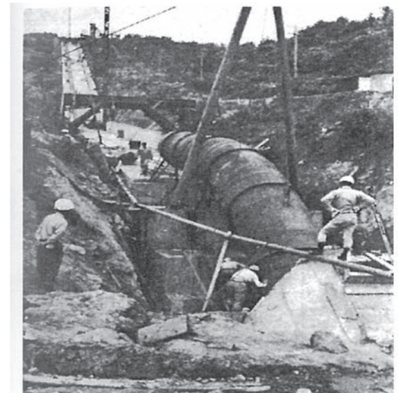
水圧鉄管の布設(北海道電力七飯発電所工事記録 昭和39年)
