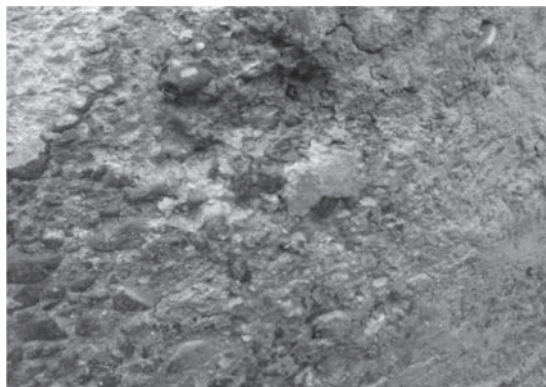
写真-2 既設水路壁の損傷状況
