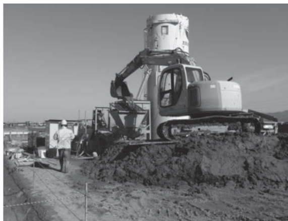
写真-3 流動化処理土製造プラント
