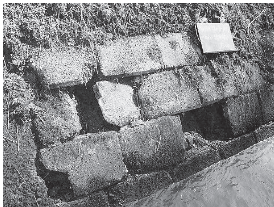
写真-5 空積ブロックの剥離状況
