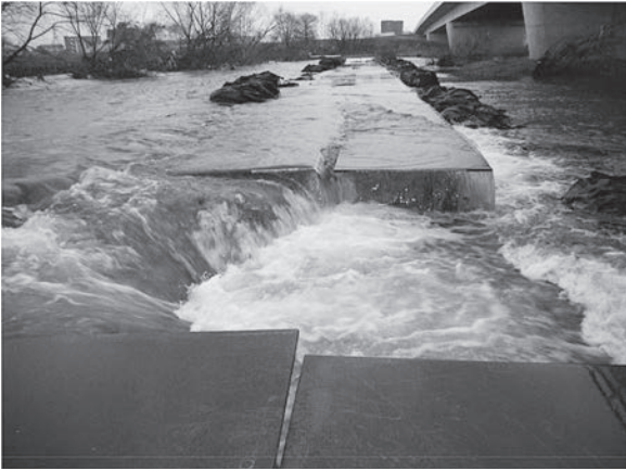
写真-12 洪水により崩壊した仮設道路
