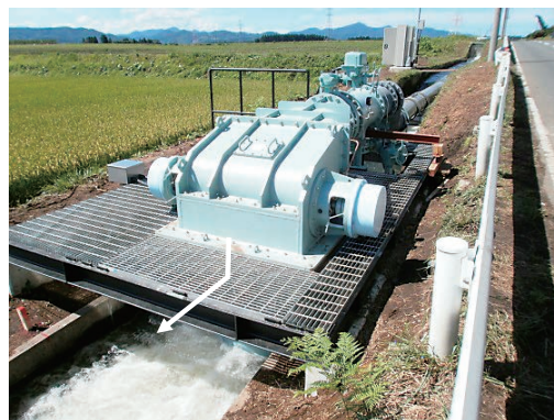
② 水車発電設備
