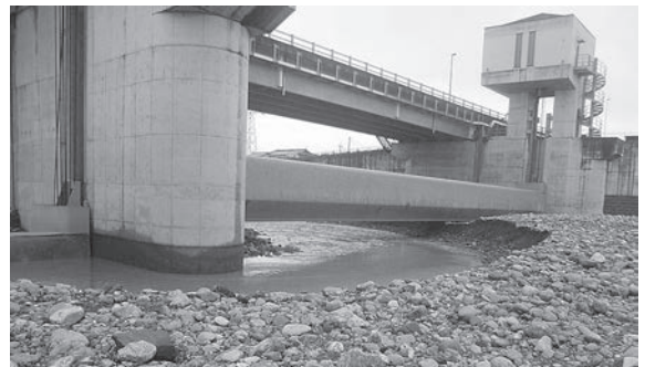
写真-9 砂利が堆積して閉塞できない洪水吐ゲート
