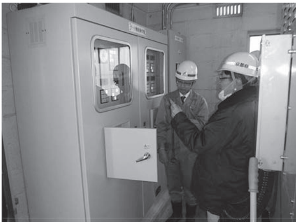
写真-9 操作盤・油圧システム
