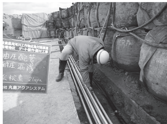
写真-10 油圧配管
