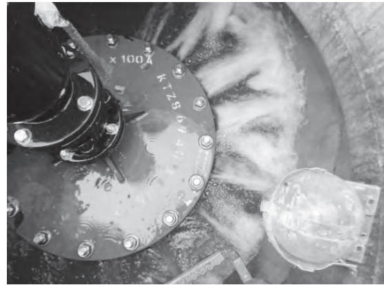
写真-3 漏水状況
