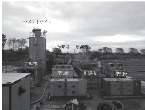
写真-1 流動化処理土製造プラント設置状況
