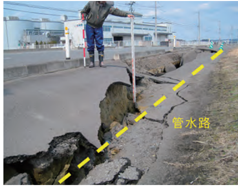
② 地震による管水路の被災状況
