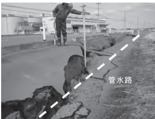
写真-1 地震による管水路上部の被災状況
