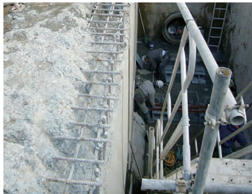
③ 頂版コンクリート撤去後露出させた鉄筋(昭和40年頃施工)
