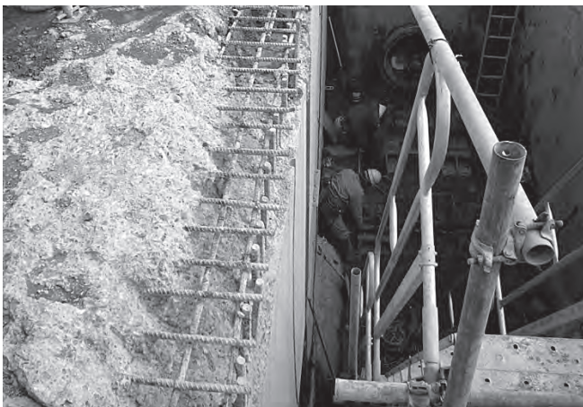
写真-3 頂版コンクリート撤去後露出させた鉄筋 (昭和40年頃施工)
