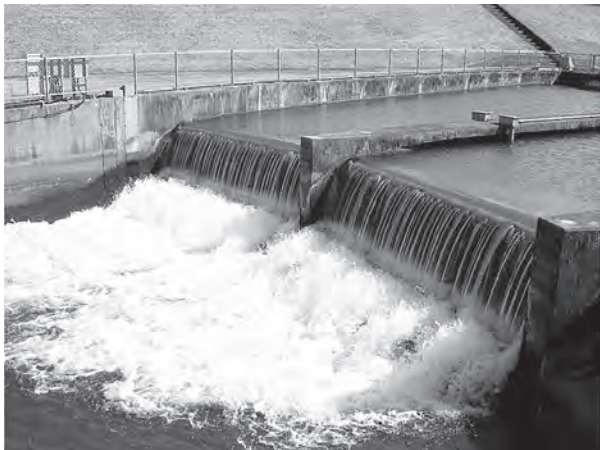
写真-3 流量調整起伏ゲート
