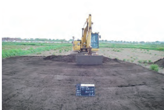
① 津波による堆積土砂の鋤取り撤去状況 (宮城県名取市)
