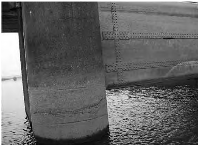
写真-4 堰柱及び扉体スキンプレート劣化状況 （5号堰柱，5号ゲート上流面）
