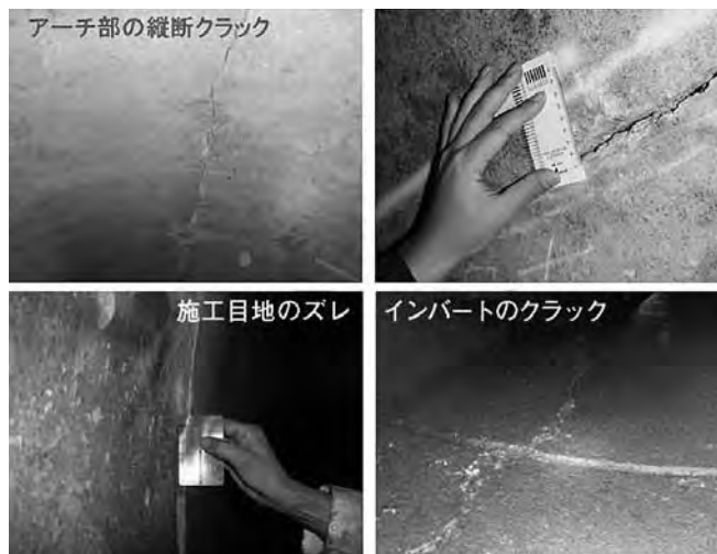
写真-1 大川瀬導水路9号・10号トンネルの変状
