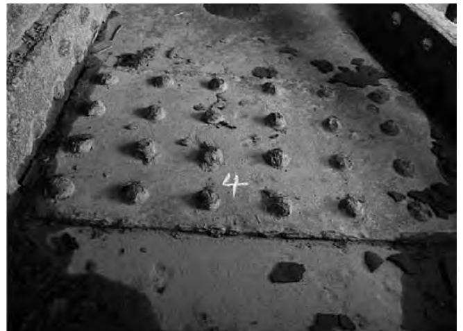
写真-5 扉体主桁添接部リベット頭部腐食状況 （4号ゲート）
