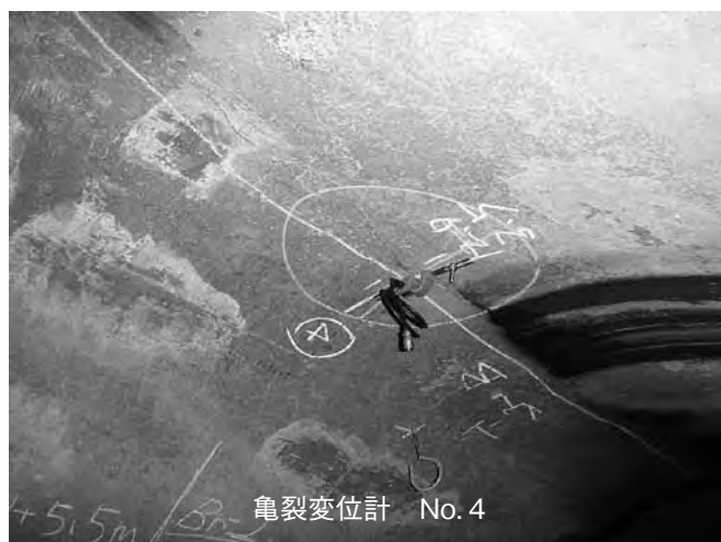
写真-5 亀裂変位計設置状況（遠景）
