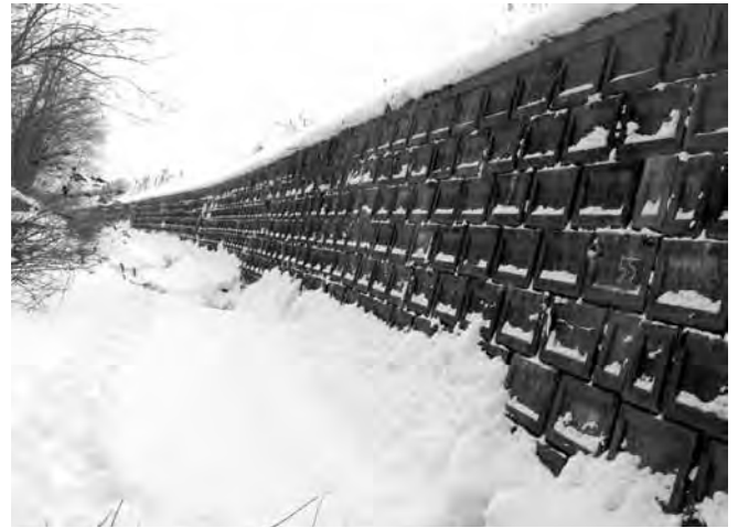
写真-2 着雪状況 (H20.2.13, 定点15)
