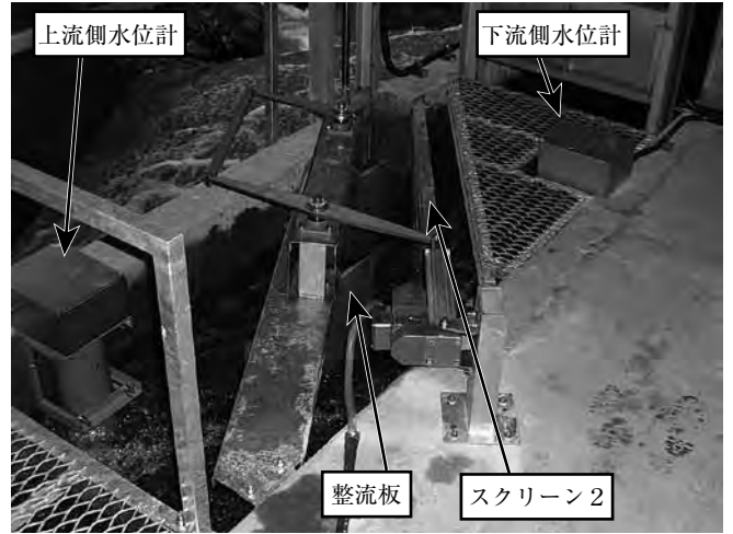
写真-6 除塵施設
