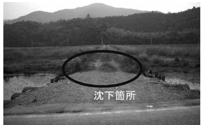
写真-4-1 農道の沈下状況写真
