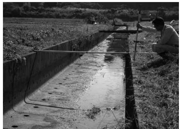
写真-4-2 排水路の変状状況写真
