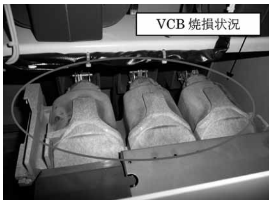
写真-4 遮断機の焼損
