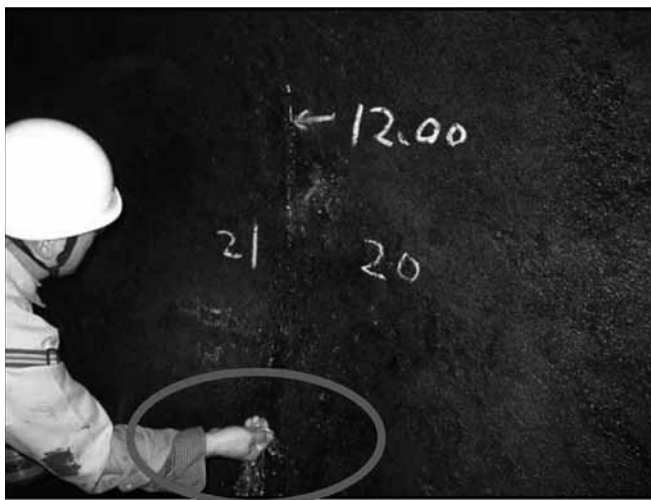
写真-1 バレル継目部漏水状況
