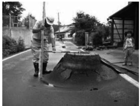
写真-2 マンホールの浮上り
