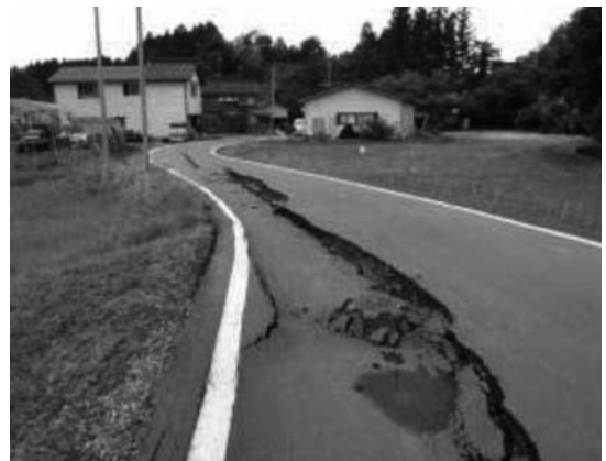
写真-1 埋設管路上部の路面陥没
