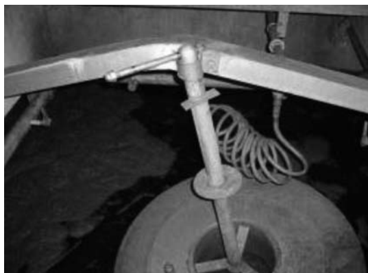
写真-5 上澄水排出装置の被災状況
