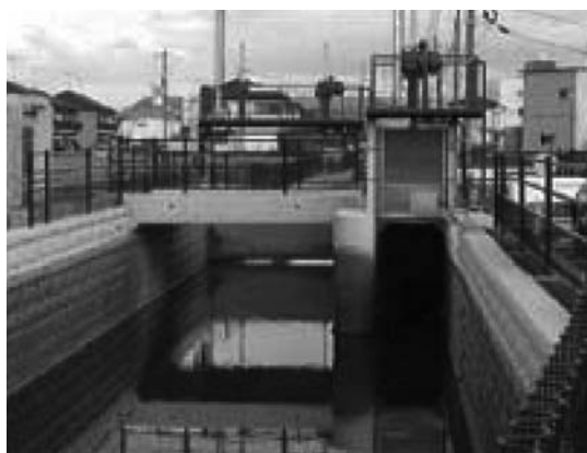
写真-7 近代化された分水施設
