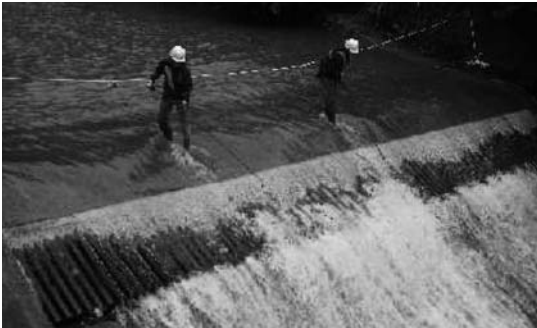
写真-3 人力による員弁川取水工バースクリーン除塵状況
