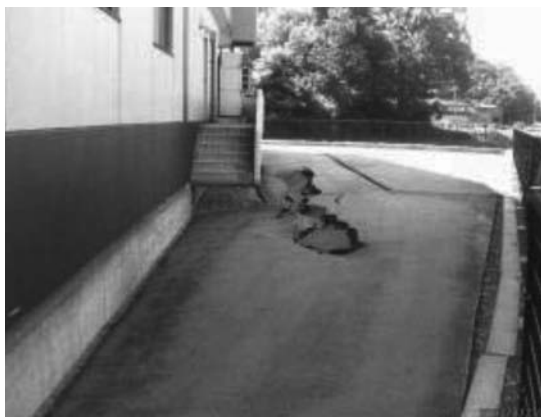
写真-4 処理施設の被害
