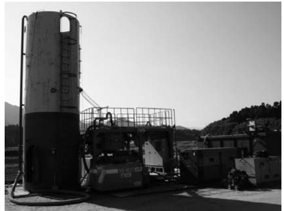
写真-2 改良材プラント
