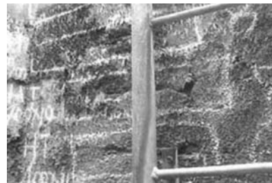
写真-4 損傷写真 (5号分水槽)
