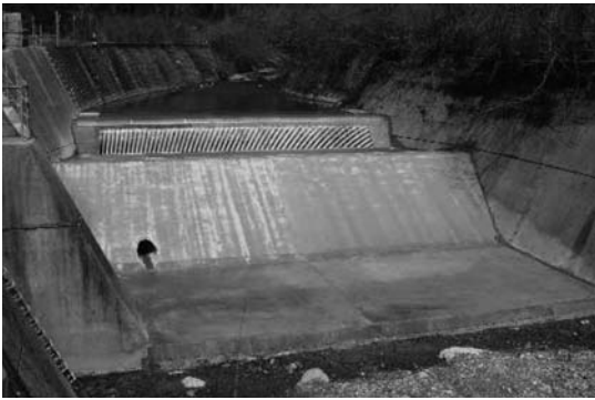
写真-7 員弁川取水工改良後（チロルⅡ型）
