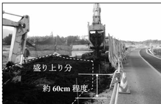
写真-6 地盤改良後の改良土盛り上り例
