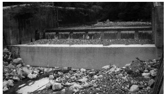
写真-1 河内谷川取水工土砂堆積状況
