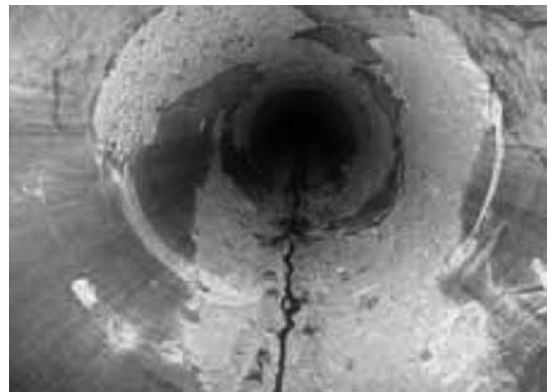
写真-2 浮き錆の発生
