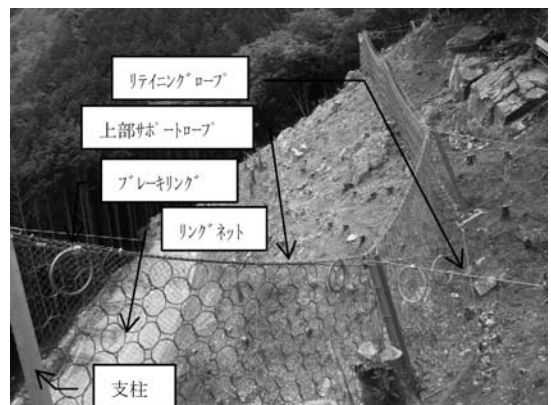
写真-9 高エネルギー吸収柵工
