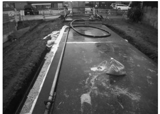
写真-7 既設水路隙間からの吹出状況
