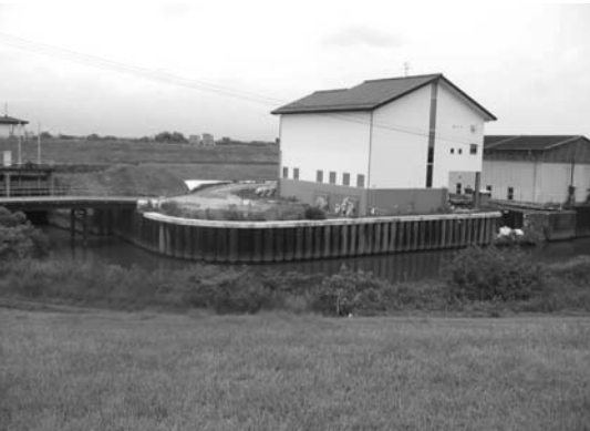
写真-1 桑原排水機場の施工状況 20～21年度にかけ樋管及び吐水槽工事を実施します。
