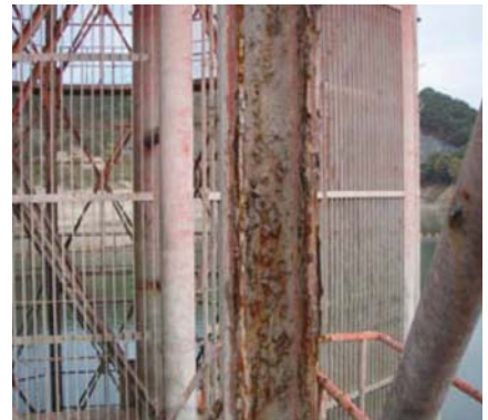
鋼材の発生状況
