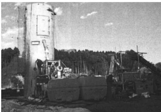
写真-6 プラント全景
