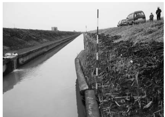
写真-2 矢板転倒の状況
