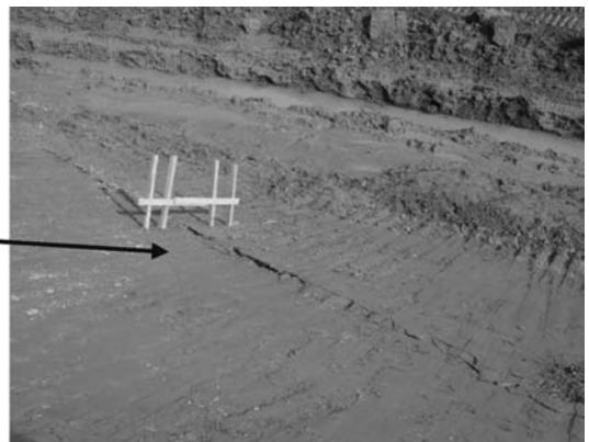
写真-6 変状状況
