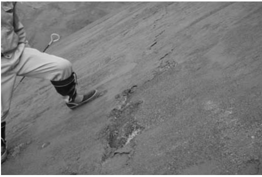
写真-7 変状状況
