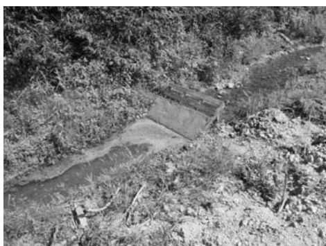
写真-3 濁水処理設備 （場内排水の流下）
