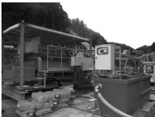
写真-2 濁水処理設備 （写真右 水管理装置及びリターンポンプ）
