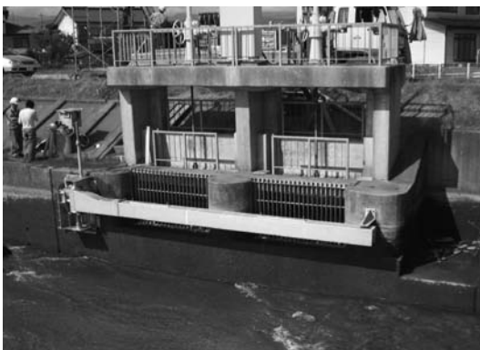
写真-9 洪水時における浮遊性塵芥流入防止装置
