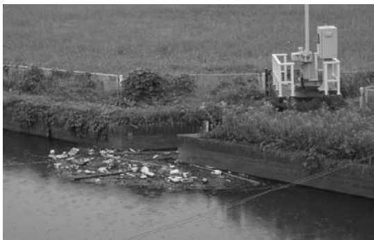
写真-1 頭首工取水口における塵芥の集積状況
