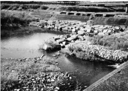
写真-2 同上頭首工の護床工被災状況
