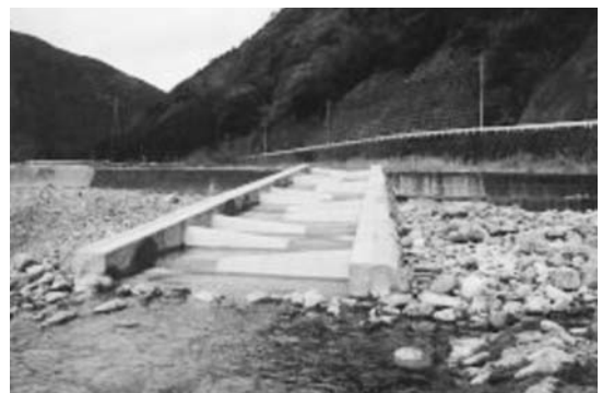
写真-9 鮎の遡上も確認されたハーフコーン式魚道（山梨県佐野川）
