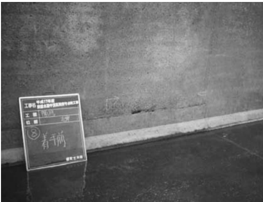
写真-1 骨材の露出状況
