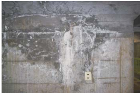
ポンプ室隔壁部劣化状況
