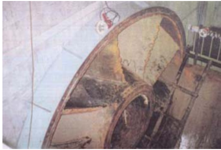
ポンプ設備劣化状況
