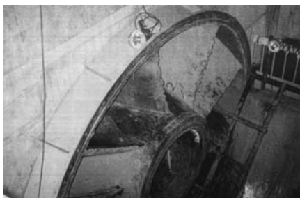
写真-1 ポンプ設備劣化状況
