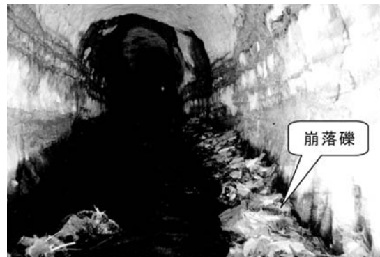
写真-1 隧道の崩落礫の状況
