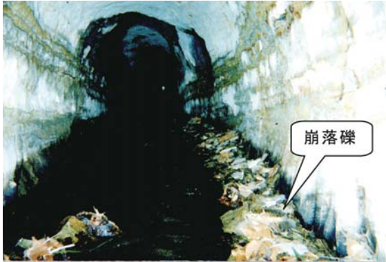
隧道の崩落礫の状況
