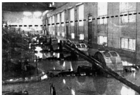
写真-3 台風13号による排水機場内の浸水 点線は最高水位 2)
