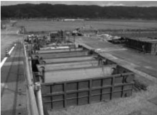
写真-8 濁水処理設備
