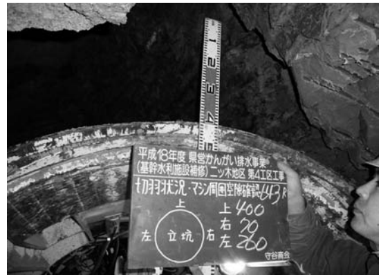
写真-1 トンネル空隙状況
