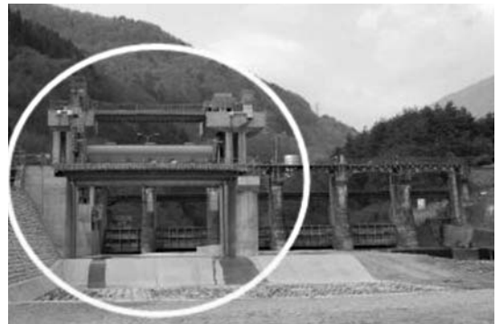
写真-4 Ⅰ期工事完了後の梓川頭首工 (既設頭首工下流、約40mに完成した土砂吐水門)
