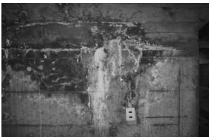
写真-2 ポンプ室隔壁部劣化状況
