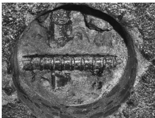
写真-6 鉄筋腐食状況確認
