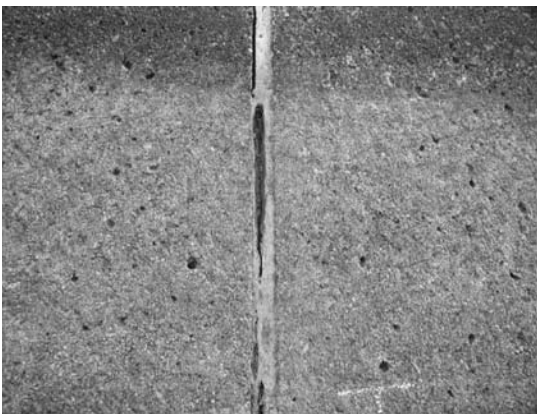
写真-2 目地の劣化状況
