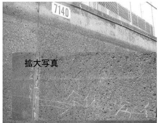
写真-4 摩耗の状況
