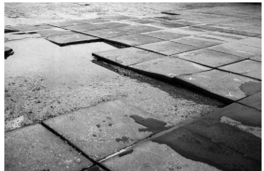
写真-5 既設耐摩耗板剥離状況
