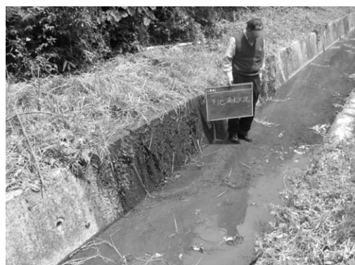
写真-2 下池左岸地山漏水状況
