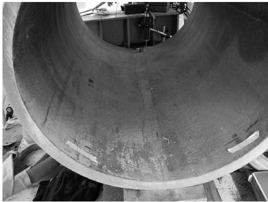
(b)管内面-管底部
