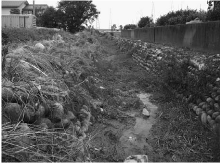
写真-2 土水路の老朽化状況
