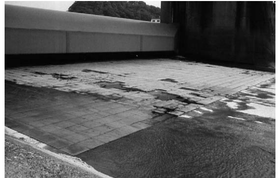
写真-4 既設耐摩耗板剥離状況（洪水吐4号）
