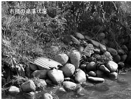
写真-3 本線(2)の老朽化状況
