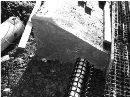
写真-6 基礎コンクリートとの密着状況
