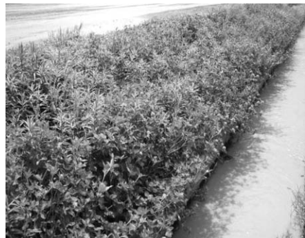
写真-2 雑草が繁茂した法面
