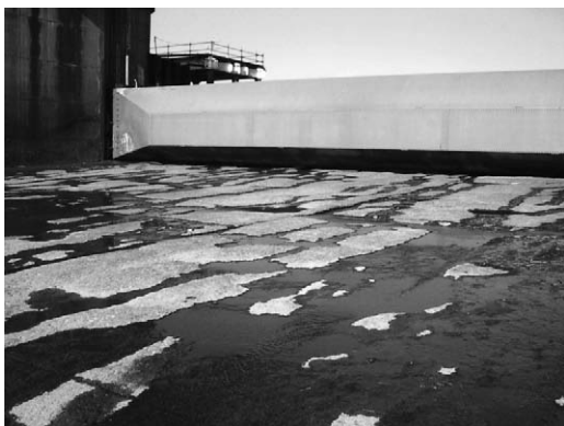
写真-5 エプロン摩耗状況
