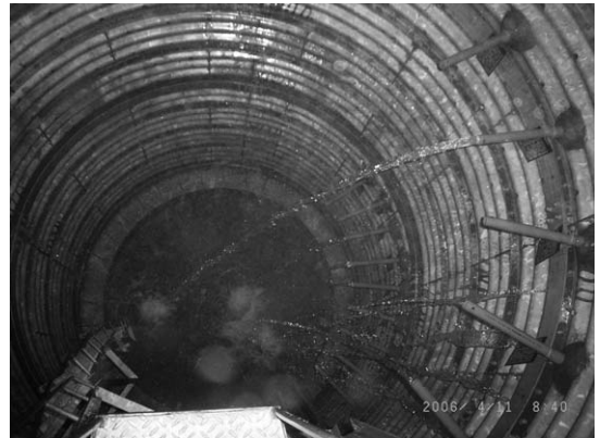
写真-1 集水井の集水状況(日雨量240mm)
