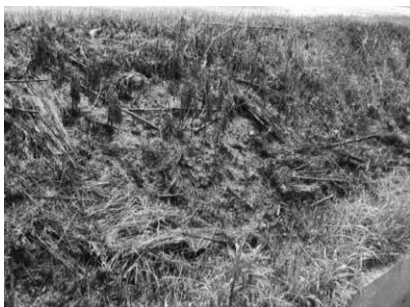
写真-3 除草剤を使用した法面
