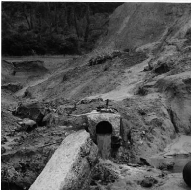
図-1 麻生池の被害状況
