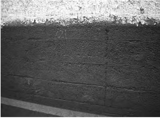
写真-2 コンクリート表面の洗出状況
