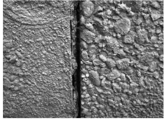
写真-4 目地ゴムの劣化状況
