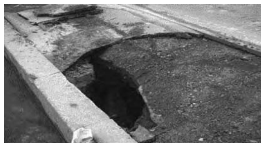
写真-2 管水路の漏水による市道陥没
