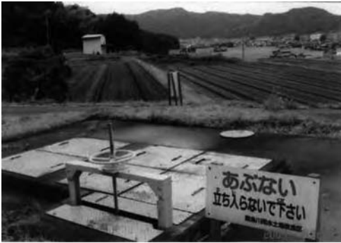
写真-11 自然流下圧利用のパイプライン化された第三ピット
