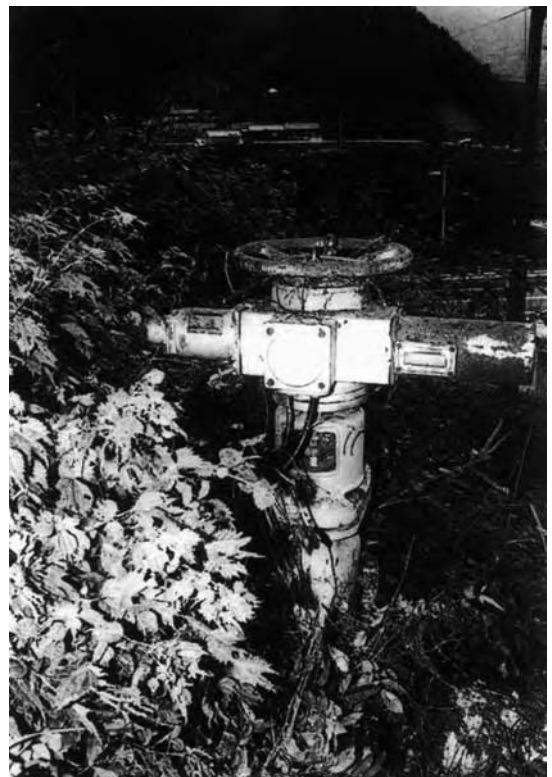
写真-8 廃棄された揚水機の止水ハンドル
