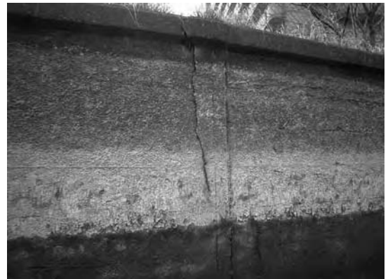
写真-5 ひび割れ状況
