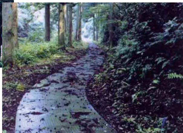
水路上面を鉄板で覆い、土砂や落葉が流入を防ぐ水路
