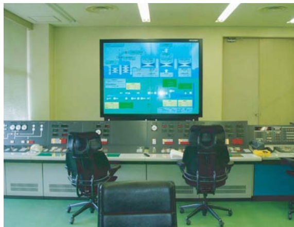
羽布ダム監視制御設備 (更新後)
