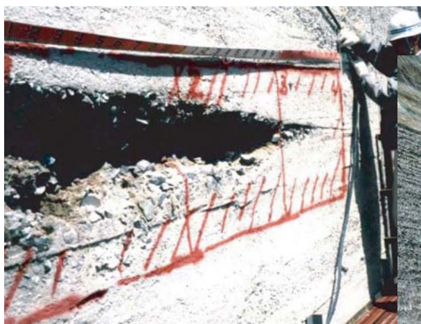
10ブロック施工不良部(上流面)
