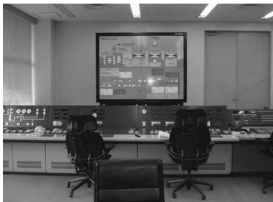
写真-6 羽布ダム監視制御設備（更新後）
