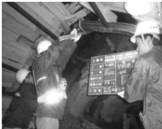
写真-1 空洞状況（169基）
