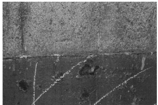
写真-6 コンクリート面と金属面の分離
