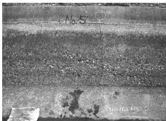
写真-4 鉛直方向に生じたひび割れ
