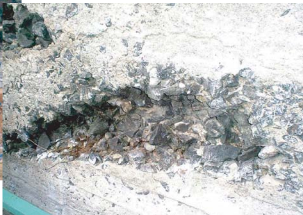
堤体上流面の劣化状況
