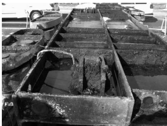
写真-7 扉体端部の腐食・損傷状況
