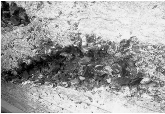
写真-4 堤体上流面の劣化状況
