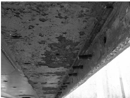
写真-1 扉体下部の腐食状況
