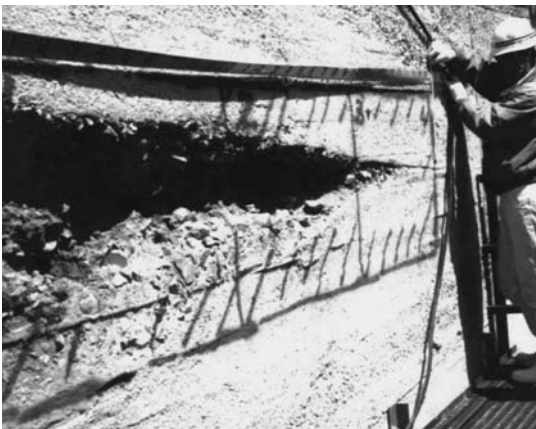
写真-5 10ブロック施工不良部（上流面）
