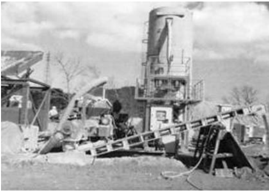
ベントナイト改良土製造プラント全景
