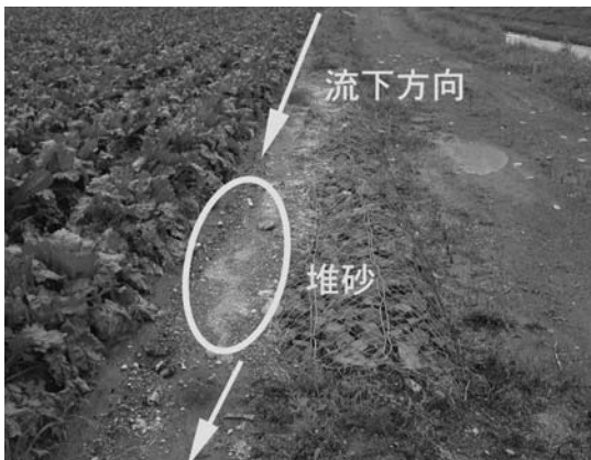
写真-6 降雨直後の保護工 (H15.8.10)
