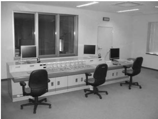
写真-2 運転管理システム
