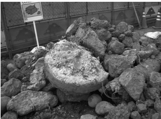
写真-4 地下埋設物（コンクリート殻）
