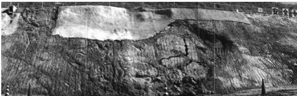
図-4 崩壊発生写真
