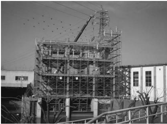
写真-5 狭隘な敷地内・高さ制限下での機場建設 板倉川調整堰（左）、現機場（右）、高圧鉄塔（後方）
