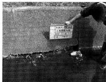
写真-3 側壁部（欠損特記参考）
