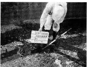
写真-6 底版基礎の空洞化
