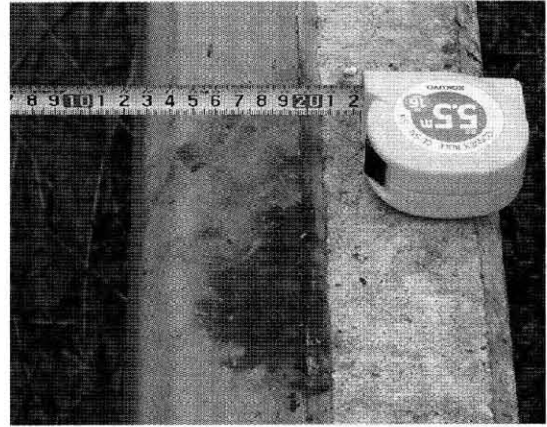
写真-5 水路天端の塗膜延焼状況
