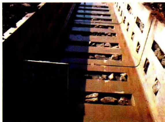
石詰U型水路
