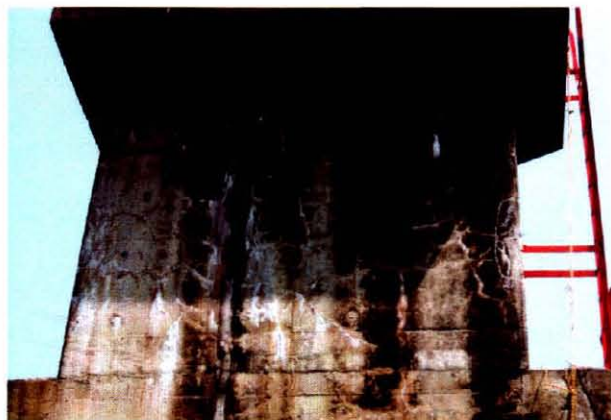
凍害により劣化した右岸側堰柱上部
