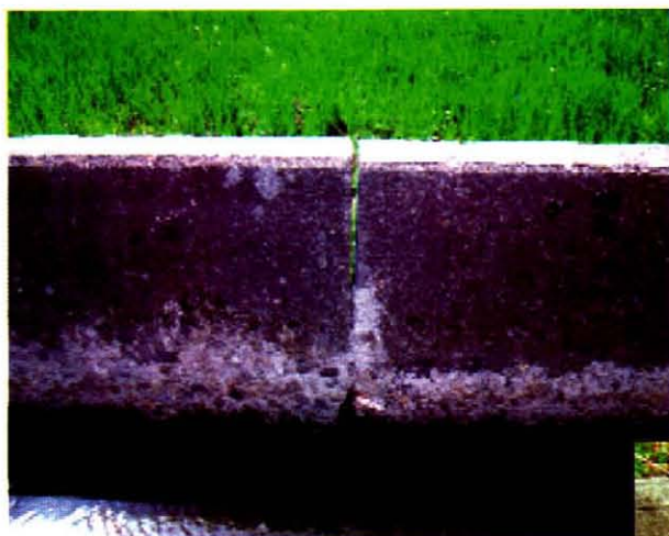
側壁の目地離れ
