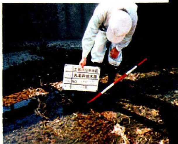
底版基礎の空洞化
