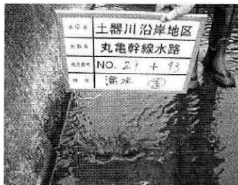
写真-2 底版の漏水状況
