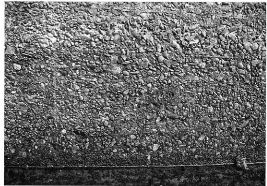
写真-6 コンクリート劣化状況
