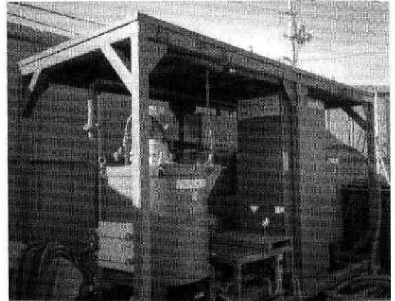
写真-4 注入プラント
