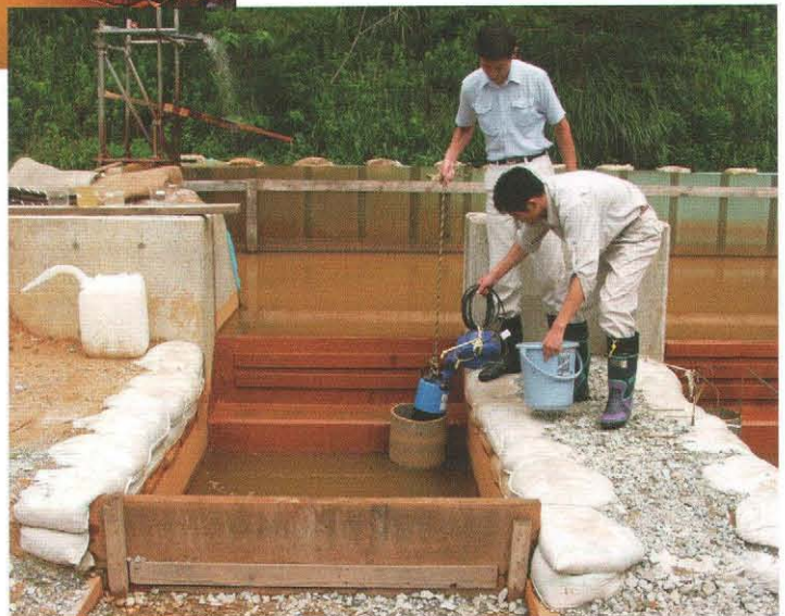
濾過槽管理施設(逆洗ポンプ)
