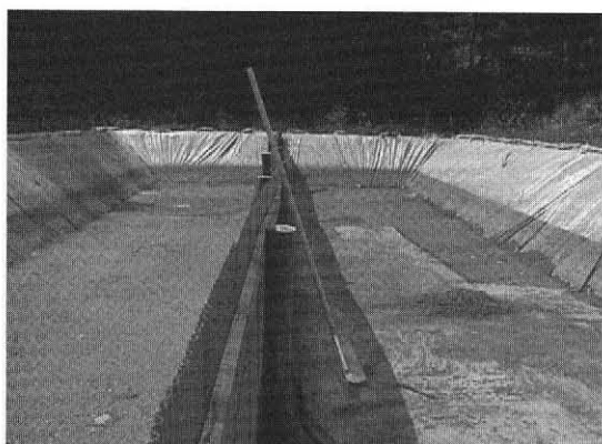
写真-11 酸化槽内に沈殿している水酸化第二鉄
