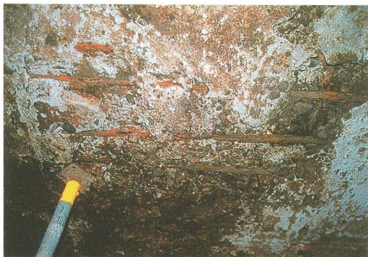
目視調査による鉄筋露出状況
