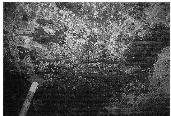
写真-1 目視調査による鉄筋露出状況
