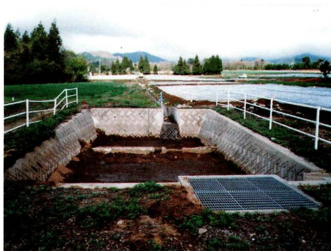
畑面沈砂池の状況
