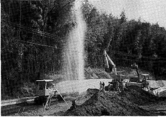
写真—2 漏水事故
