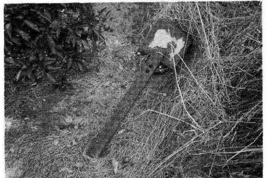
写真一 倒壊したユニットボックス
