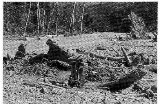
写真二 洪水被害にあった小規模かんがい用水路(1998年11月) 沈砂枡の排砂ゲートだけがよじれた格好で残っている。
