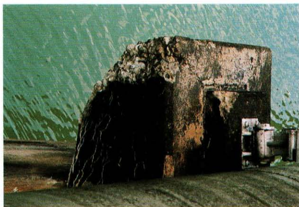
水管橋ピア張り出し部における劣化状況 (凍結融解, 1966年築造)
