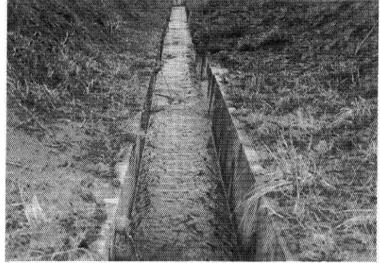
平成11年3月19日の降雨（10mm）後の状況 （写真一 3-2）
