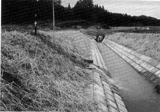
平成11年3月15日の降雨（32mm）後の状況 （写真一 3-1）
