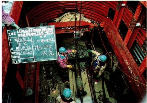
土砂排出状況
