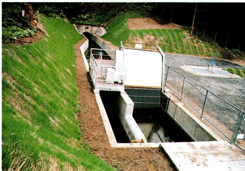
無動力除塵機
