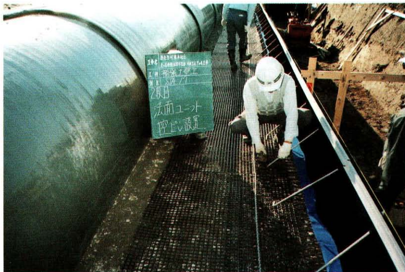
大口径管理設部における ジオテキスタイルを用いた補強土壁 工法について (本文25頁)
