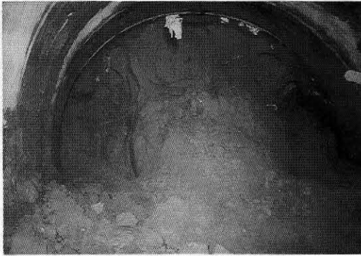
写真一 安全のため芯をのこして掘削したが周囲が崩落し、拡大して行く。
