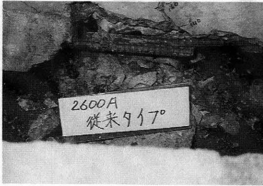
写真一七 破壊後の鉄筋状況
