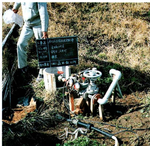
パイプライン末端設置の安全弁
