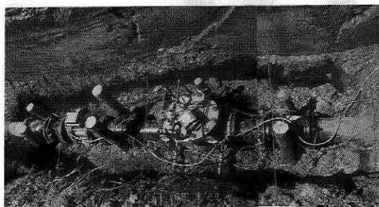
写真一 自動減圧弁
