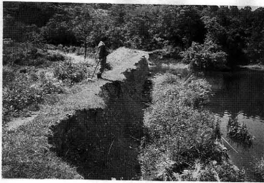
写真一 兵庫県南部地震で被災した二六池の画像の出力例
