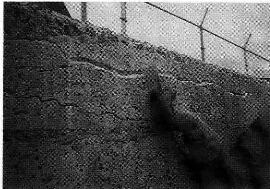
写真—1 顕在化したひびわれ (上井分水工 側壁水面下)
