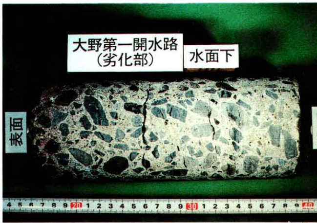
粗骨材・モルタルのわれ (大野第1開水路 壁面水面下) (本文58頁)
