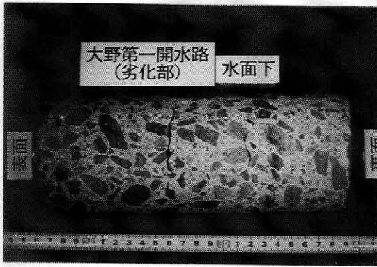
写真—2 粗骨材・モルタルのわれ (大野第1開水路 壁面水面下)
