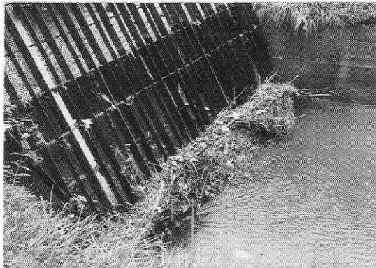
写真-2 この型式のスクリーンは、41ヶ所あり、下部は除塵できない。草木・ビニール類で通水断面は、20～30%縮小されている。
