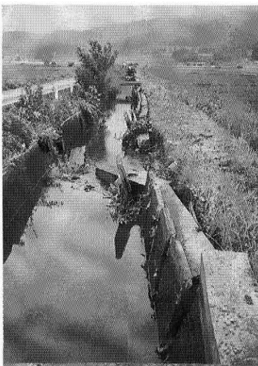
写真一6 大野地区 中央幹線用水路のL型ブロック倒壊状況
