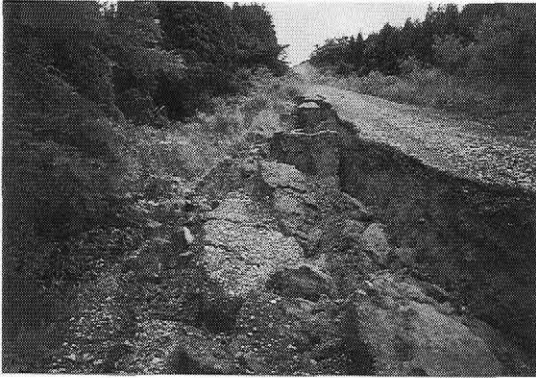
写真一 五厘沢地区 第9号支線道路被災状況
