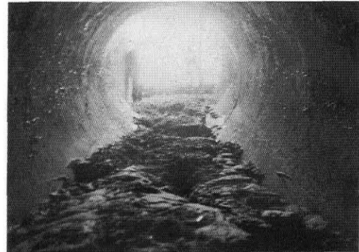
写真-3 サイホン出口ベント部の堆積状況 堆積深 約40cm
