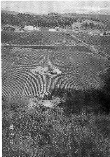
写真一5 北桧山右岸地区 管水路地表の陥没状況
