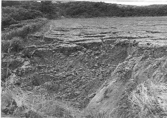
写真二 相和地区 農地排水路被災状況
