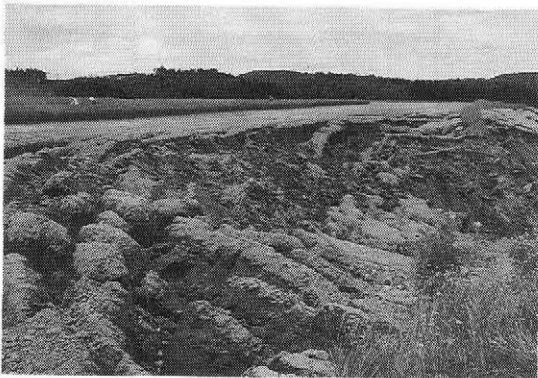
写真三 五厘沢地区 農地排水路被災状況
