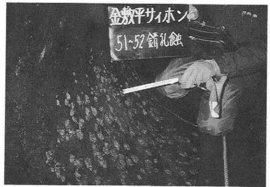
写真-7 金敷平サイホンの異形管錆発生状況 異形管、短管には錆コブが全面に発生している。孔食深は1mm～2.5mm程度。
