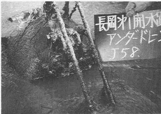
写真一 3 長岡第1開水路のアンダドレイン状況 金属部の腐食及び土砂等で閉塞しており大半が機能していない。
