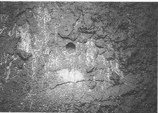
写真一 4 柏木沢第3開水路のウィーブホール状況 フラップバルブが欠落し土砂等で閉塞している。
