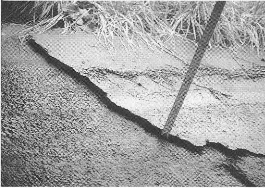
写真一 2 矢原開水路のクラック状況 クラックが進行しパネル面の段差がみられる。
