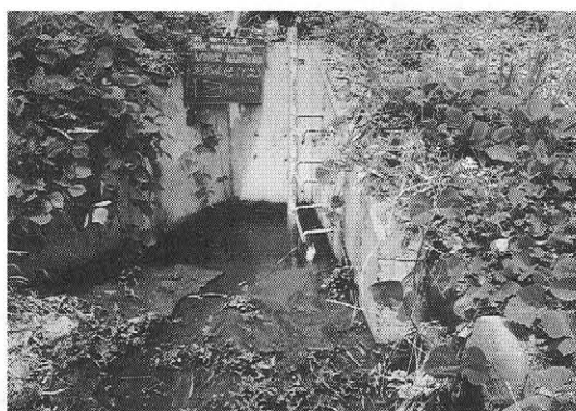
写真-10 横断排水施設の土砂堆積状況
