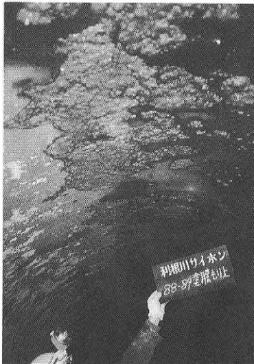
写真-6 利根川サイホン水管橋サビ状況 錆や腐食が進行し、錆コブが発生している。孔食深は1mm～3mm程度。
