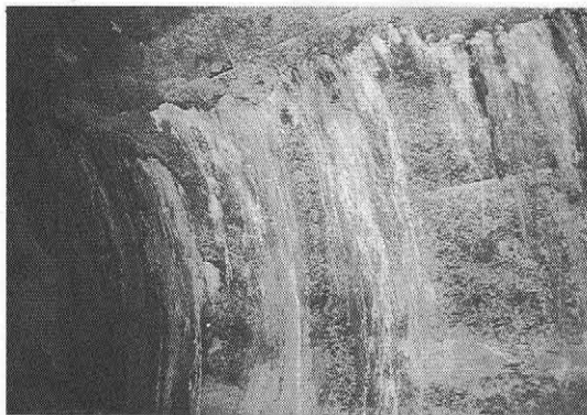
写真一 8 双林寺トンネルのクラック状況 巾2mm～3mmのクラックが発生し、裏込注入剤が流れ出している。
