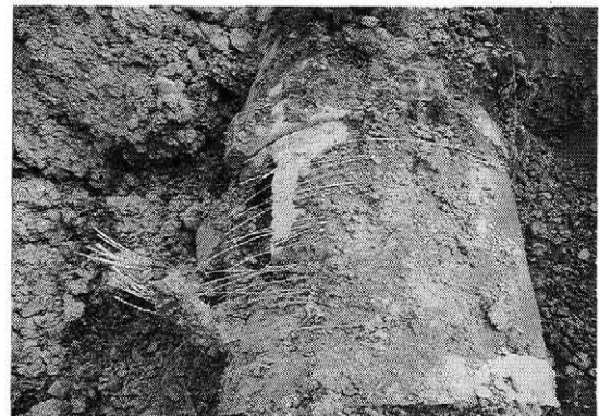
写真-3 H4.9.27 六野原導水路 PCφ1000 破裂現場
