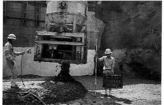
6.5tのケーブルクレーンにより運搬され、2.0m 2 コンクリートバケットにより打設
