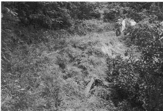
写真-2 浸食状況
