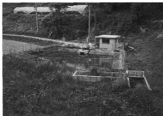
写真-1 貯水池 (圧力水槽式) : 末端クローズドパイプライン
