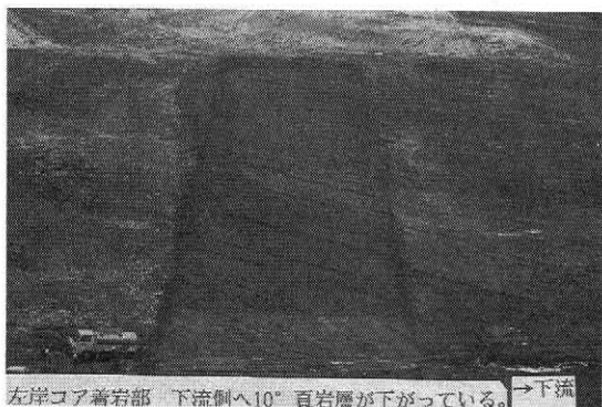
写真-1 左岸コア着岩部 下流側へ10°頁岩層が下がっている。右側が下流
